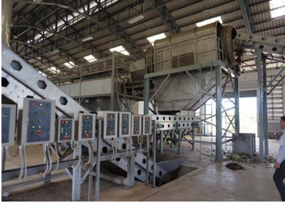
(ง) ชุดควบคุมสายพานคัดแยกขยะ
